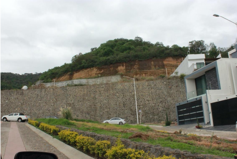
Figura 41. Paredones de concreto en fraccionamiento en área colindante del ANP municipal Los Ocotillos, 16 de julio, 2021
